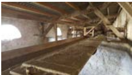
Intérieur du bâtiment: la vis sans fin se trouve sous la planche
